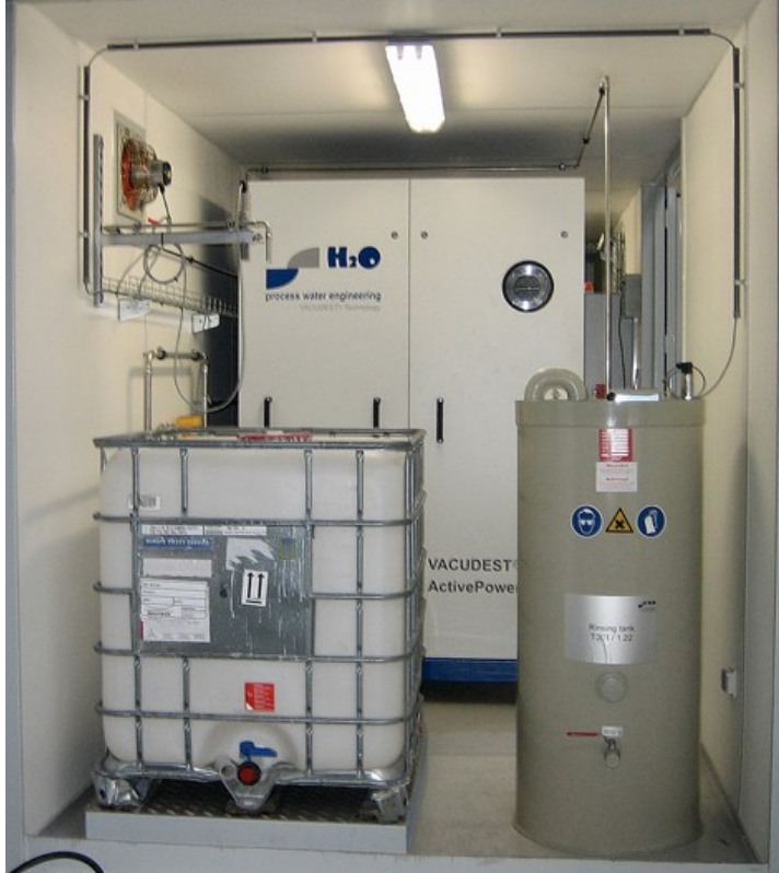
Vacuümdestillatie-installatie voor de zuivering van een koelemulsie (capaciteit: 1.000 m 3 /jaar)
